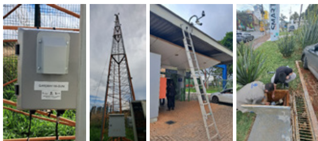
Figura 9 – Equipamentos instalados para realização dos testes de campo.
